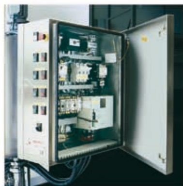
Quadro elettrico Electrical
